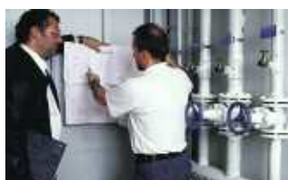
Unklarheiten schnell beseitigt: Gerade wo Leitungspläne fehlen, sind die Wasser-Spezialisten in ihrem Element. Sie erfassen Verlauf, Nennweiten, Material und Problemstellen in Ihrer Gebäude-
