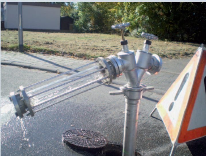
BILD 7: Funktionsprüfung der Schieber aufgrund Wasseraustritt am Auspeisehydranten: Schlecht schließende Schieber – erhöhter Wasseraustritt am Schauglas (oben); Ausreichend schließende Schieber – geringer Wasseraustritt am Schauglas (unten)
