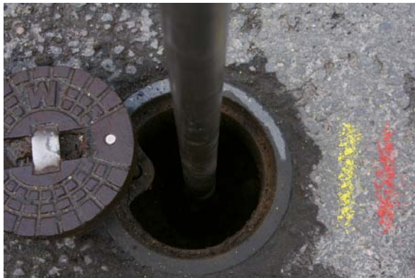
Bild 4: Kennzeichnung an Straßenkappe nach Überprüfung
