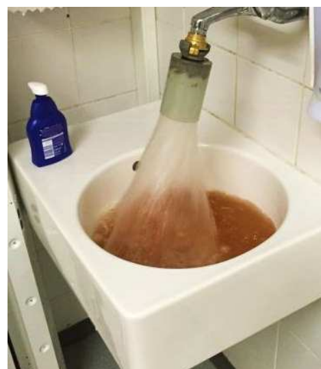
Abbildung 2: Ausspeisung über Waschbecken mit Zyklonabscheider (Archivbild)
