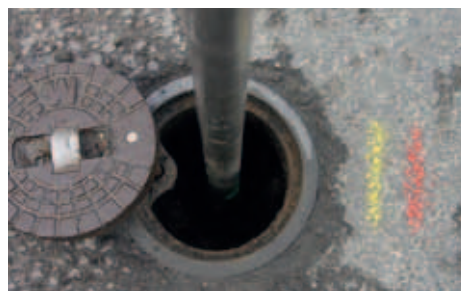
Schieber geprüft und mangelhaft
