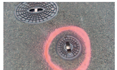
Schieber defekt - bauliche Maßnahme erforderlich
