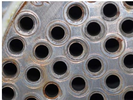
Abbildung 3: Zustand des Wärmeübertragers nach der Comprex®-Reinigung
