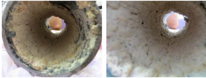
Abbildung 1: ursprünglicher Zustand der Rohrleitung mit Ablagerungen
