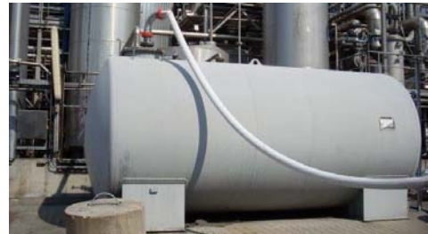
Abbildung 3: zentrale Auspeisung in Tank zur Spülwasseraufbereitung
