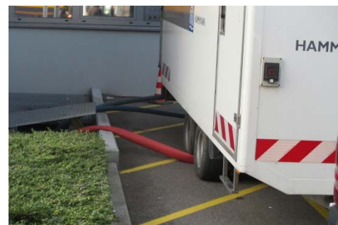
Abbildung 3: Ein- und Ausspeisung von Luft und Wasser außerhalb des Gebäudes
