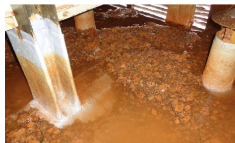
Abbildung 4: Ausspeisung von Luft, Wasser und entfernten Ablagerungen in Kühlturmtasse
