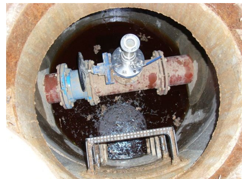
Abbildung 3: Einspeisung über Adapteranschlüsse an BEV
