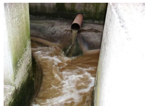
Abbildung 4: Ausspeisung in Kanal
