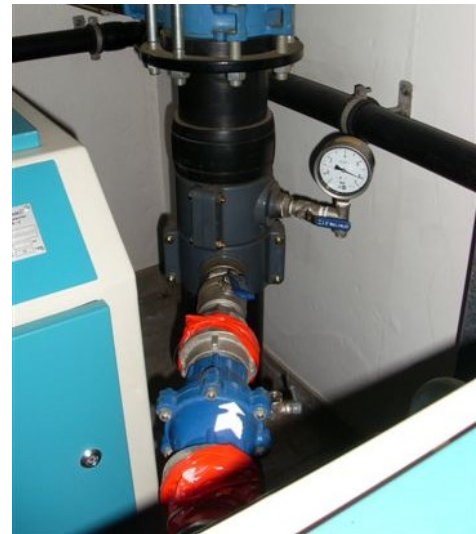
Abbildung 2: Einspeisung an Pumpwerk
