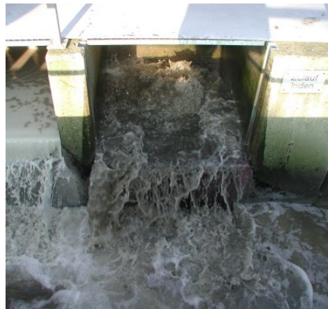
Abbildung 3: Ausspeisung in Klärwerk
