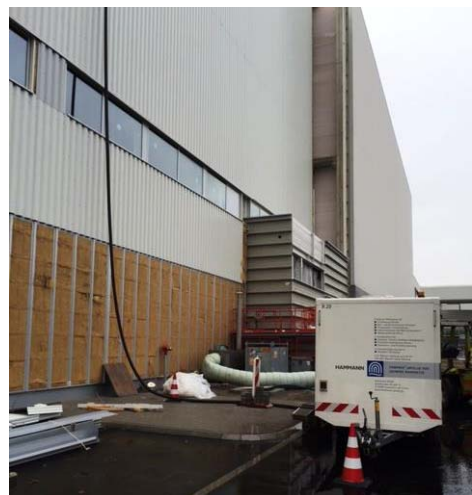
Abbildung 4: Lufteinspeisung mit Comprex®-Einheit vor dem Gebäude
