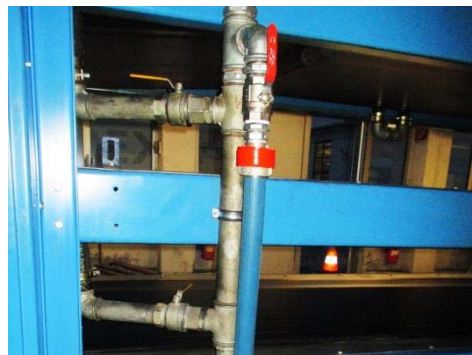
Abbildung 3: Zugang zum System über Adapteranschlüsse (Einspeisung)
