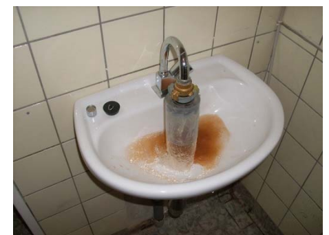
Abbildung 3: Trübung bei Ausspeisung über Waschbecken
