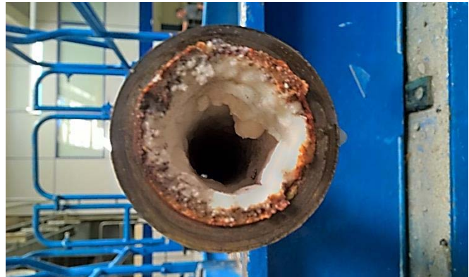
Abbildung 1: Ablagerungen aus Kalkseife in Rohrleitung DN 50
