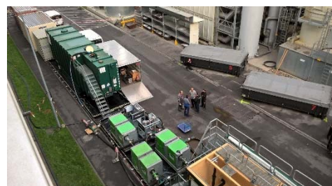
Abb. 3: mobile Aufbereitungsanlage für Kreislaufbetrieb der Spülmedium
