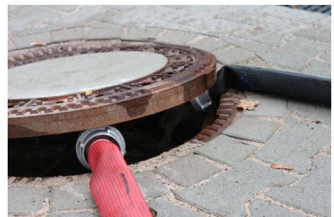
Abbildung 4: Ausspeisung in Schacht
