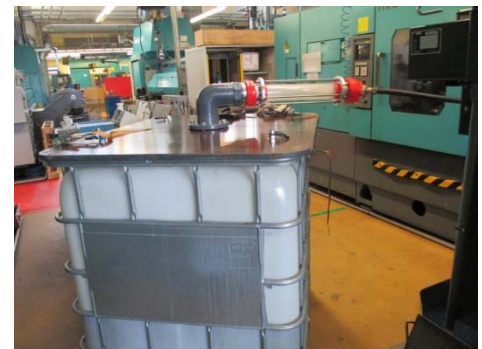
Abbildung 4: Ausspeisung von Spülwasser mit Ablagerungen in IBC
