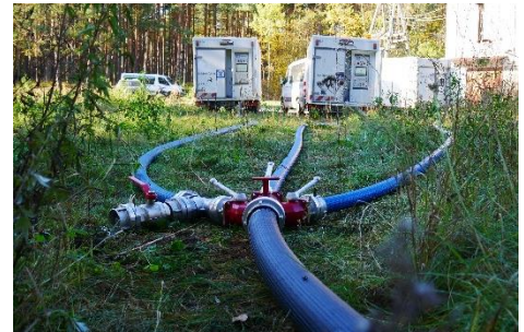
Abbildung 3: synchronisierte Einspeisung über Adapteranschlüsse
