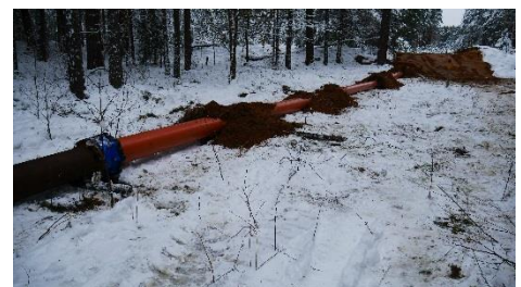
Abbildung 4: temporäre Rohrleitung zur Ausspeisung
