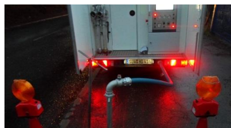
Abbildung 2: Einspeisung über Hydrant mit Standrohr
