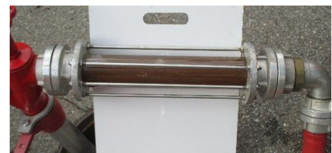
Abbildung 4: Trübung in Schauglas während der Reinigung
