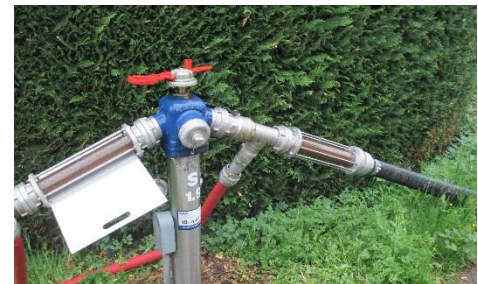
Abbildung 3: Ausspeisung über Hydrant mit Schaugläsern
