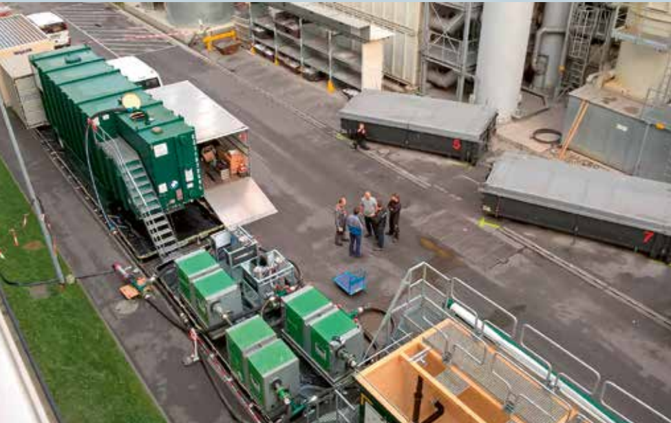
2 Equipment für die Kreislaufführung und Entsorgung des Spülwassers in mobilen Tanks vor dem Gebäude der Kurbelgehäusefertigung (© Hammann)
