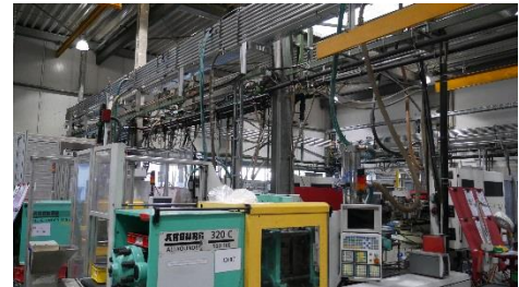
Abbildung 2: Rohrleitungssystem an den Spritzgießmaschinen
