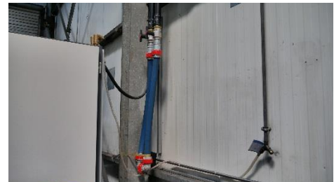
Abbildung 3: Temporärer Bypass zwischen Vor- und Rücklauf der Hauptleitung
