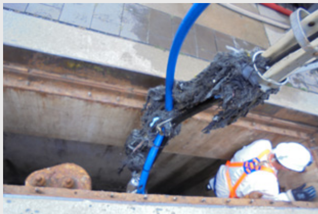
Bild 7: Herausziehen des schwarzen Spülschlauchs mit Spüldüse und daran befestigtem blauen PE-Rohr sowie Ansammlung anhaftender Feuchttücher und Vliesstoffe
