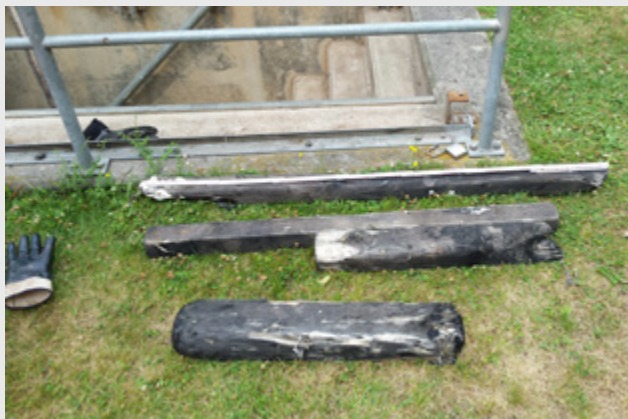
Bild 6: Ausgetragene Holzteile am Eingang zum Auslaufbauwerk
