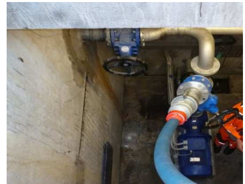
Abbildung 2: Einspeisung der Comprex®-Impulse im Pumpwerk
