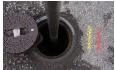
Abbildung 3: Schieber funktioniert nicht
