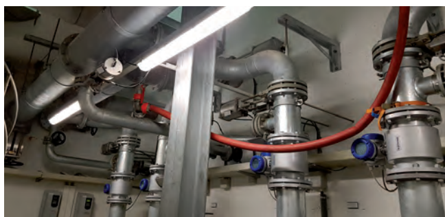
Abb. 5: Drucklufteinspeisung im Pumpwerk Küsnacht
