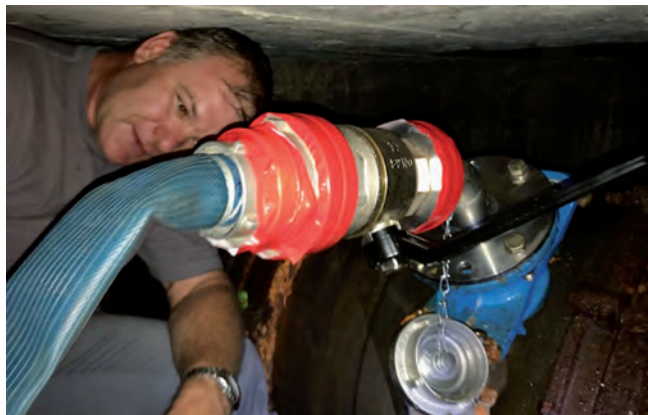
Abb. 4: Druckluftanschluss beim Zwischeneinspeisepunkt
