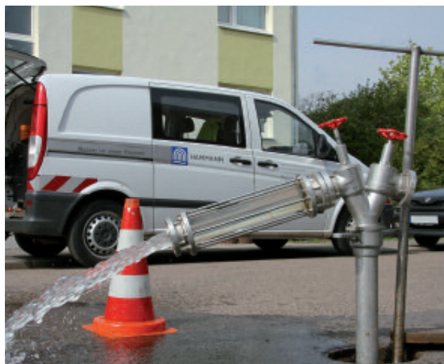
Abb. 2: Nicht schließender Schieber, erkennbar am Wasseraustritt
