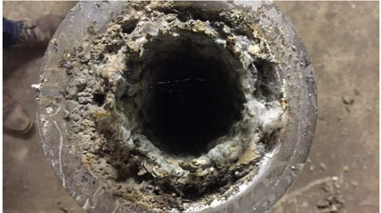
Abbildung 1: Primärschlammleitung vor der Comprex®-Reinigung
