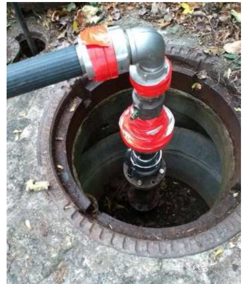
Abbildung 2: Einspeisung in Schacht
