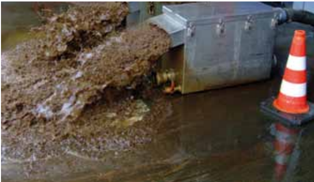
Abb. 10: Ausspeisung des Spülwassers über Spülboxen während der Complex-Reinigung von Vor- und Rücklaufleitungen DN 250
