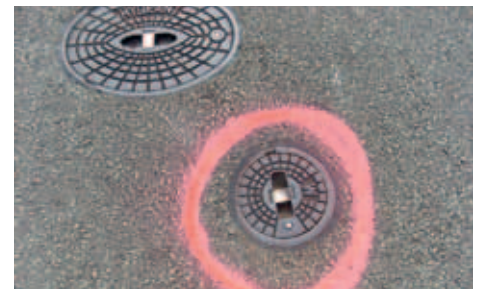
Schieber defekt - bauliche Maßnahme erforderlich
