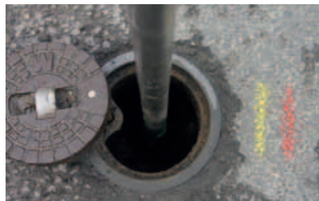
Schieber geprüft und mangelhaft
