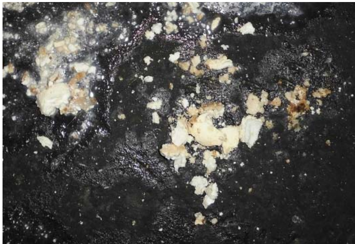
Abbildung 6: Aus dem System ausgetragene Ablagerungen
