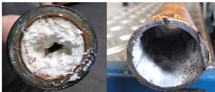
Abbildung 1: wachstartige Ablagerungen in KSS-Rohrleitung vor und nach der Comprex®-Reinigung
