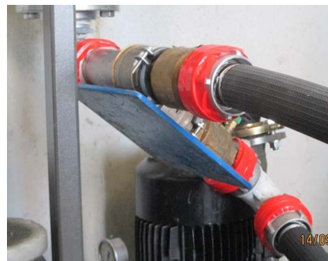
Abbildung 2: Einspeisepunkt für Luft und Wasser
