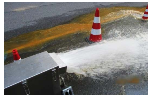
Abbildung 4: nachlassende Trübung des Spülwassers am Ende der Reinigung
