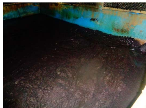
Abbildung 4: aus dem System entfernte Ablagerungen in Kühlturmtasse
