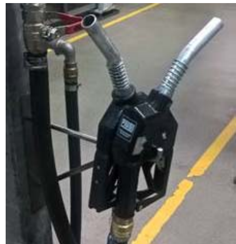
Abbildung 2: Zapfstellen am KSS-System
