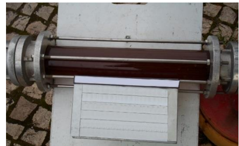
Abbildung 4: Schauglas während der Reinigung
