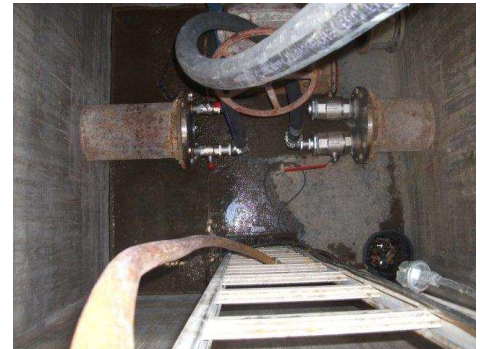
Abbildung 2: Einspeisung von Wasser und Luft in Schacht
