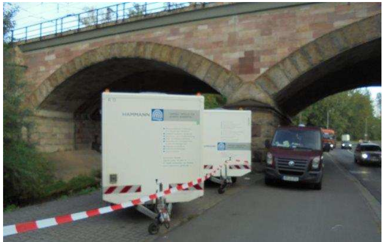
Abbildung 1: synchronisierte Comprex®-Einheiten im Einsatz
