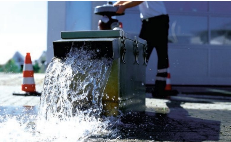
Abb. 2 – Spülbox an der Ausspeisestelle
