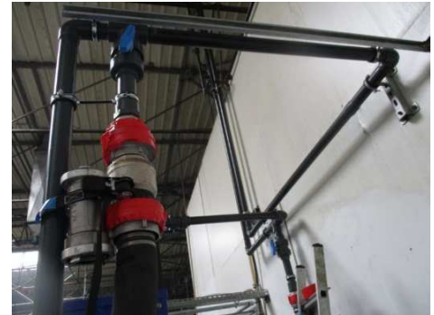
Abbildung 2: KSS-Rohrleitungen aus PVC
