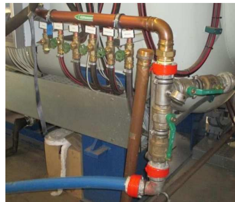
Abbildung 2: Anschlüsse am Vorlauf des Kühlkreislaufes
