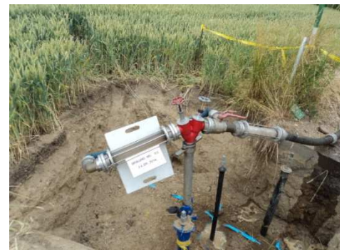
Abbildung 3: Ausspeisung über Hydranten
