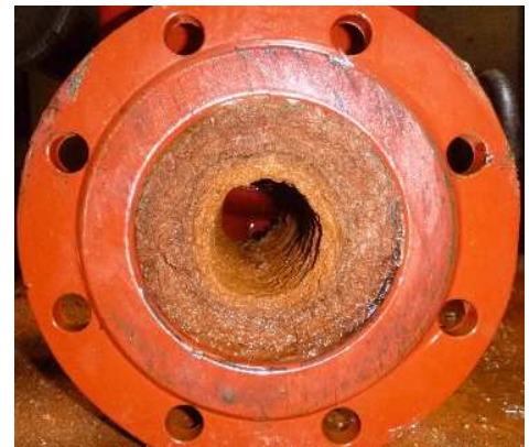
Abbildung 2: Zustand vor der Reinigung
