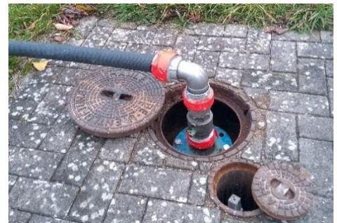
Abbildung 3: Einspeisung über Be- und Entlüfter (BEV)
