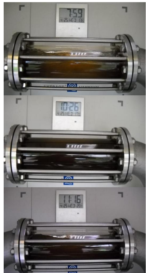
Abbildung 3: Trübung in Schauglas während der Wasser-Saug-Spülung
