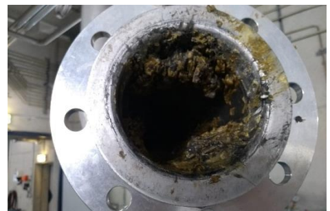
Abbildung 2: Überspeisepunkt Rohrende vor der Reinigung
