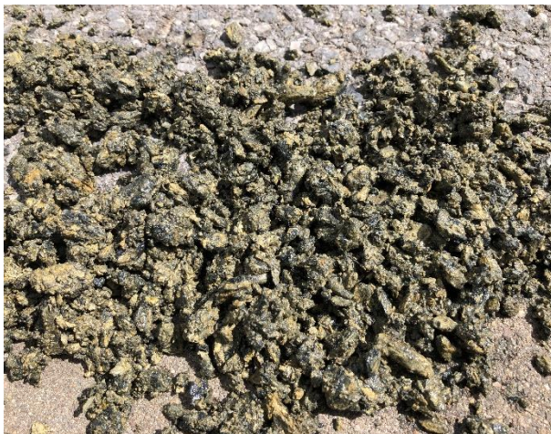
Abbildung 9: Konsistenz der Schlammablagerungen
