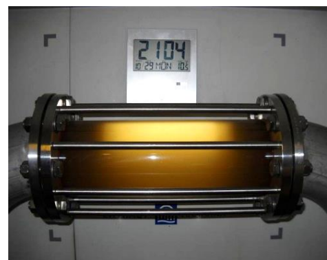
Abbildung 4: Verfolgen des Trübungsverlaufes im Schauglas
