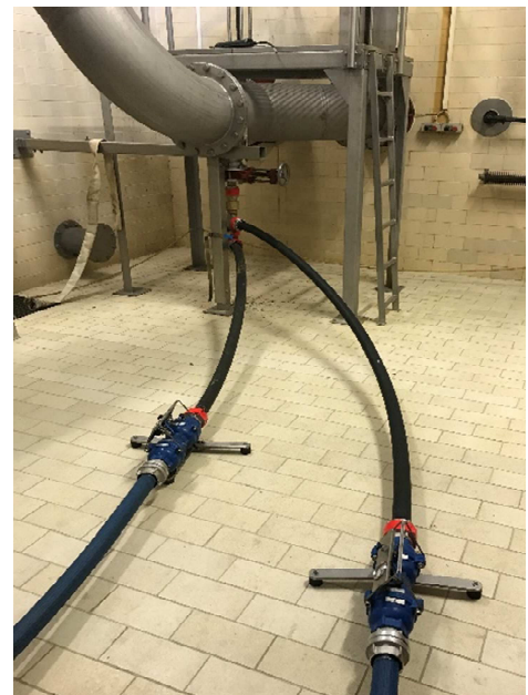
Abbildung 2: Einspeisung im Pumpwerk
